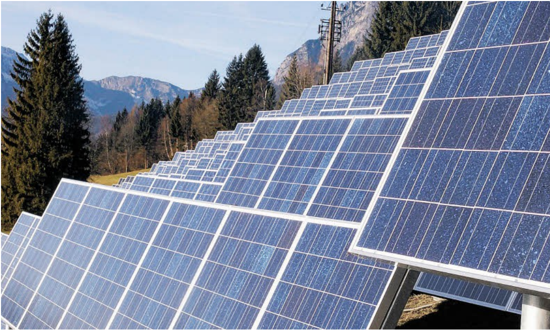
Ein Bild aus besseren Zeiten, Die PV-Anlage auf dem Eulersberg in Werfenweng ist mittlerweile beschädigt.
