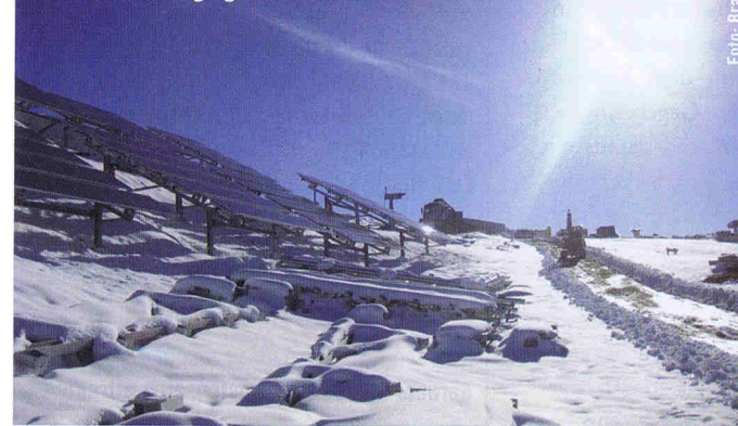
Eine Aufnahme vom August, als bereits 1 Meter Schnee am Gipfel des Wildkogels lag. Die Photovoltaik-Anlage ist auf diese Bedingungen vorbereitet.
